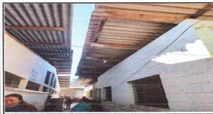
Foto 5: Se observa deterioro de la estructura de madera en vigas y costaneras. Modulo 4
