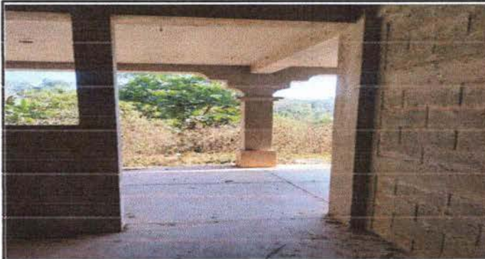
Foto 3: Se observa falta de puertas formales. Modulo 1
