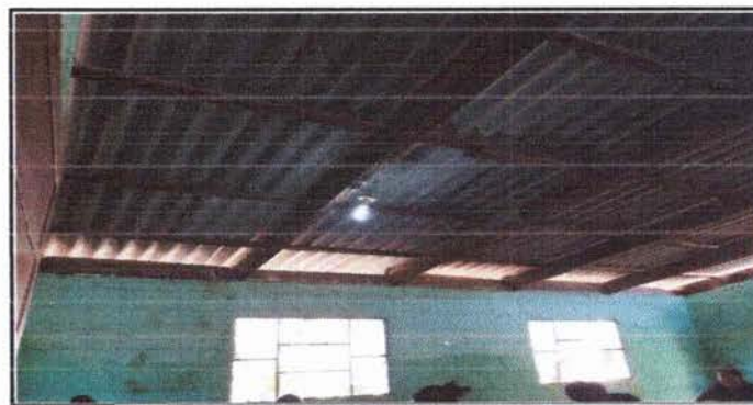
Foto 6: Se observa deterioro del techo que es material antiguo y con agujeros. Modulo 4
