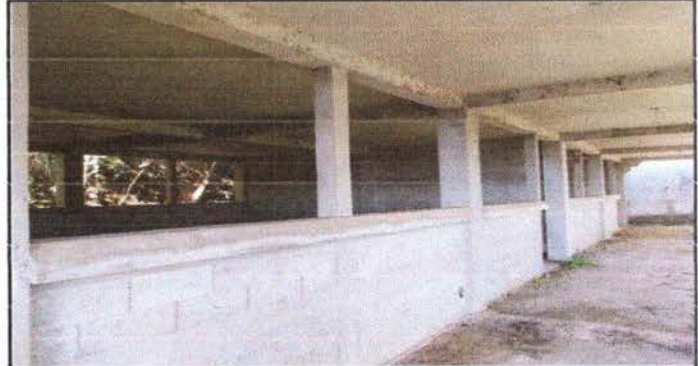
Foto 4: Se observa falta de piso de cemento. Modulo 1
