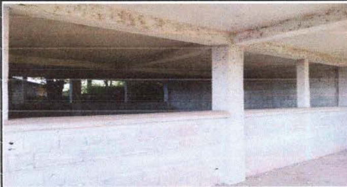
Foto 1: Se observa ausencia de los valcones. Modulo 1
