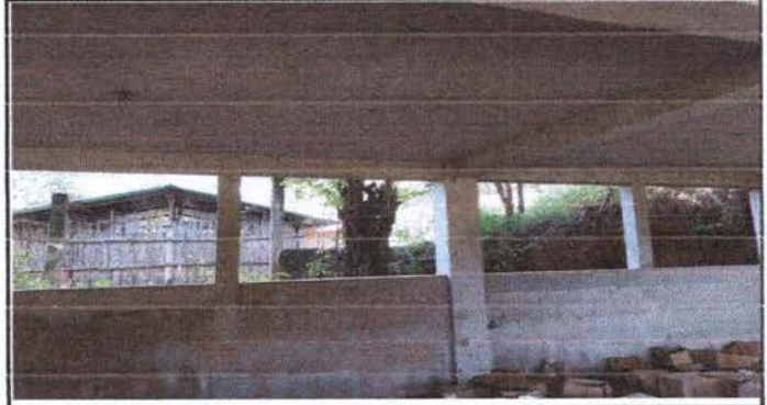
Foto 2: Se observa falta de valcones. Modulo 1
