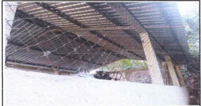
Foto 4: Ausencia de balcones Modulo 2.
