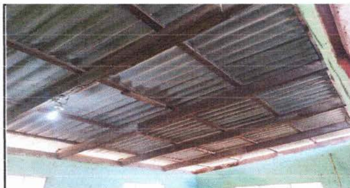
Foto 3: Se observa deterioro de las laminas de duralina. Modulo 4
